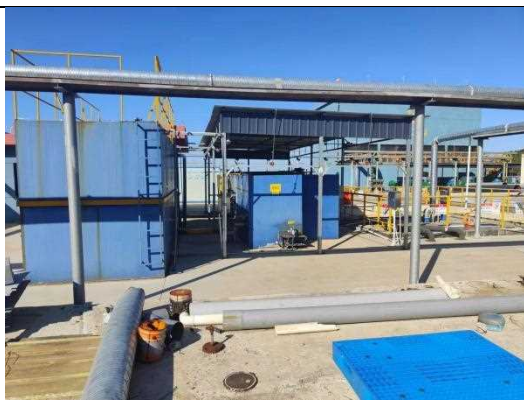
污水排口及废水处理
