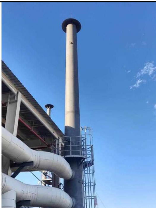
( 排污许可编号 ) 导热油锅炉 排气筒
